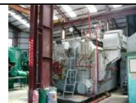
備註：水管式鍋爐
