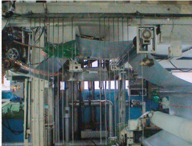
於工作機台附近之人員進出處，裝設除靜電垂簾，以消除累積於人體之靜電。
