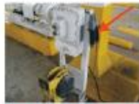
槽車接地安全措施
