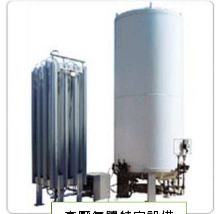
高壓氣體特定設備 液氮儲槽
